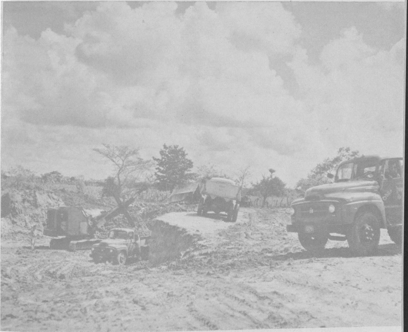
Maquinaria de la Secretaría de Obras Públicas en el frente de la troncal oriental durante su construcción.
